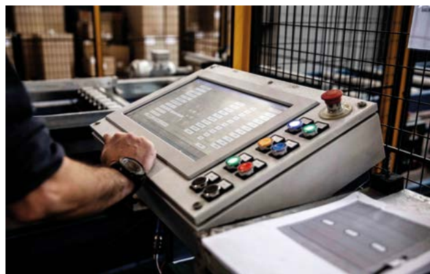
Sistema di controllo automatizzato. Automated control system.
